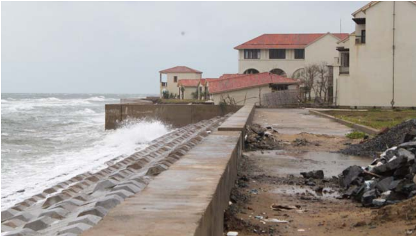
Hình 7: Hội An đang "trượt" dần xuống biển - Resort Fusion Alya bị nhấn xuống biển (Ảnh: Axel Neubert)
